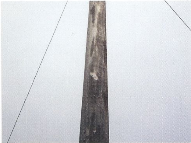
▲腐蝕している鋼管ポール
