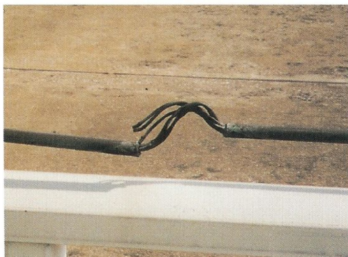
▲棟上導体用エキスパンションが断線しています。
