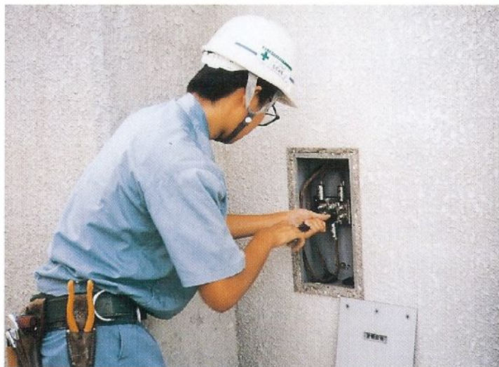
▲専門技術者が端子箱を検査しています。
